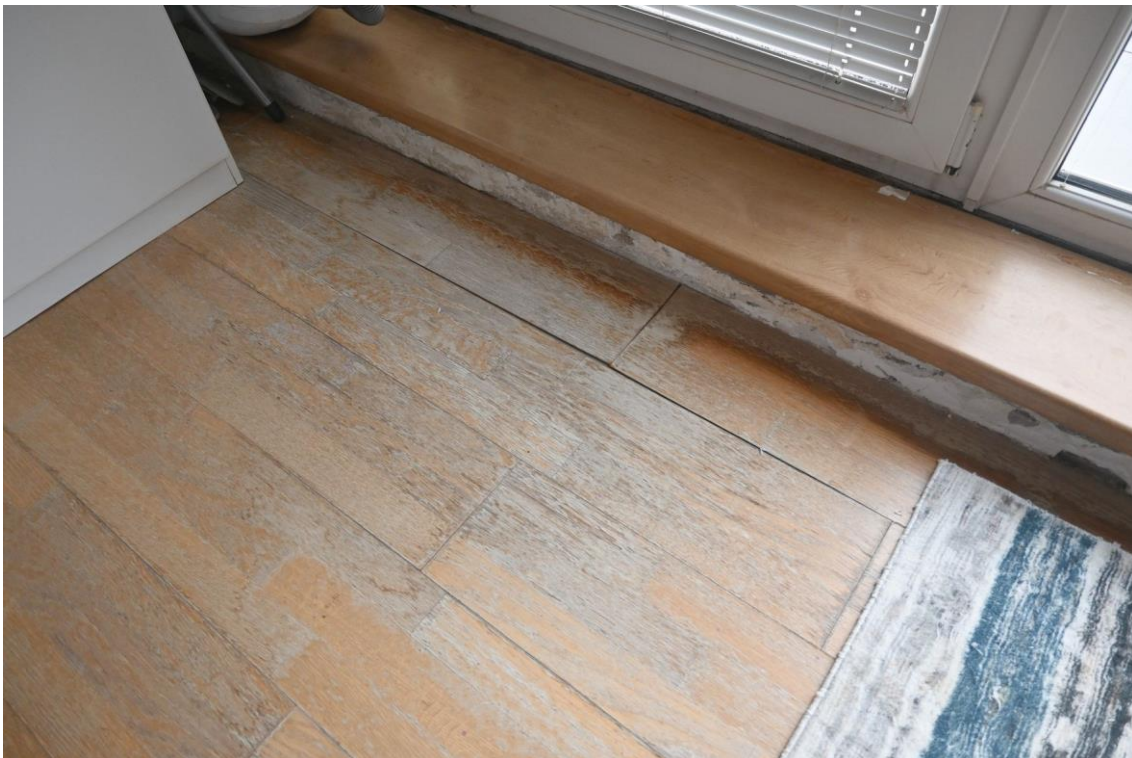
Poškozená podlaha, zatékání
